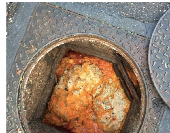
Accumulation de graisse retrouvée dans le réseau d'eaux usées
