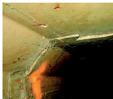
Début d'effondrement dans un réseau
