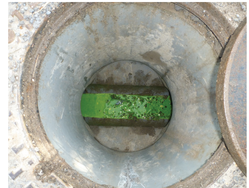
Contrôle de conformité à la fluoresceine, permettant de suivre les eaux usées
