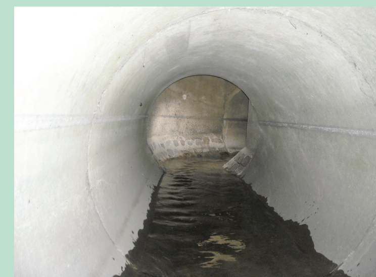
Collecteur d'eaux pluviales
